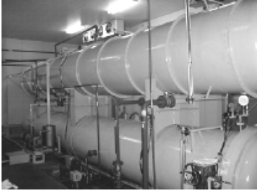
エコアコールウッド注入管設備
